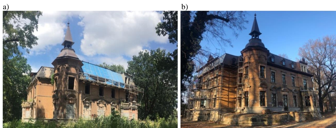
Fot. 2. Pałac w Rzuchowie: a – stan zabytku w czerwcu 2018 r., b – stan zabytku w grudniu 2020 r.
